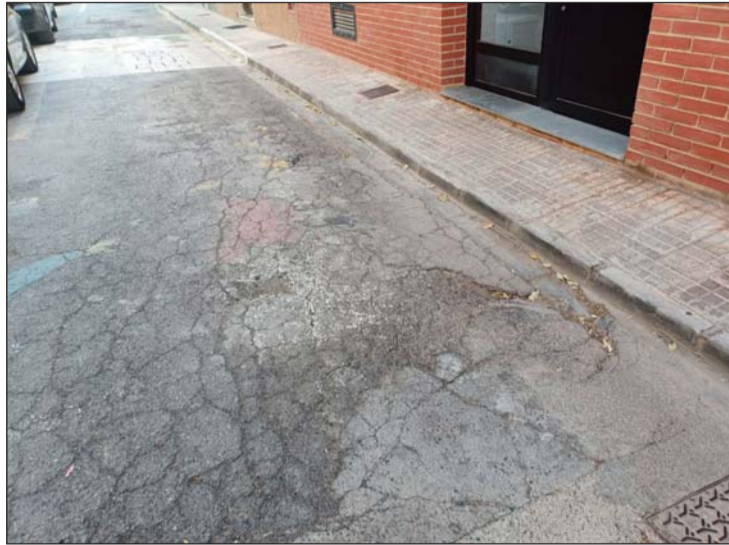
El deterioro del asfaltado, también se localiza en esta zona
